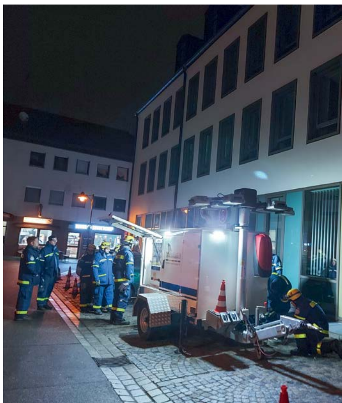
Notstromspeisung in das Landratsamt
